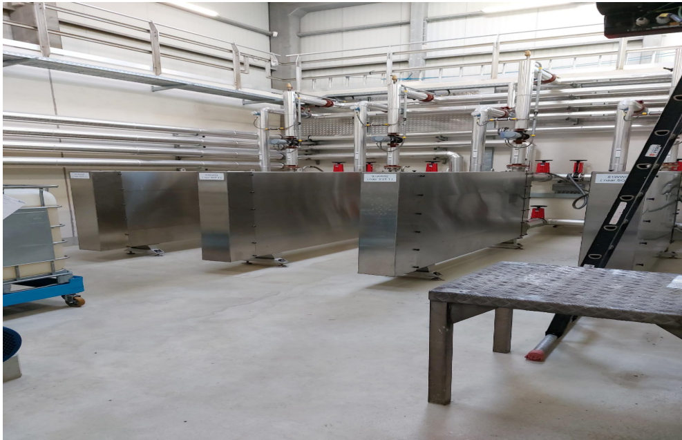
FIGUUR 3.4 VIER 'BUIS-IN-MANTEL' SLIB/WATER WARMTEWISSELAARS OP RWZI BATH, ZEELAND. TWEE WARMTEWISSELAARS PER SLIBGISTING
