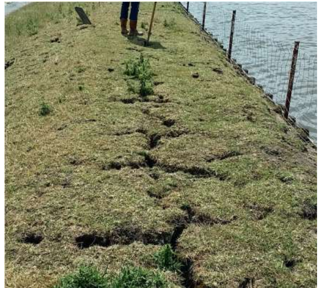
Figuur 5-12 Dijk in Delfland met droogtescheuren (Ponsteen et al., z.d.)
