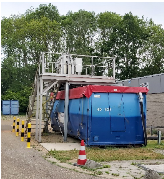
AFBEELDING 3.3 TROMMELZEEF BOVEN CONTAINER DIE DIENST DOET ALS BUFFER OM PERIODEN ZONDER AANVOER VAN RIOOLWATER TE OVERBRUGGEN EN CONTINU BEDRIJVEN VAN DE PILOT MOGELIJK TE MAKEN
